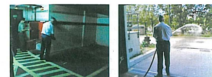
Figura 1 - Teste às bocas-de-incêndio dum parque de estacionamento
