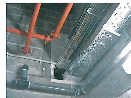
Figura 2 - Selagem corta-fogo violada
